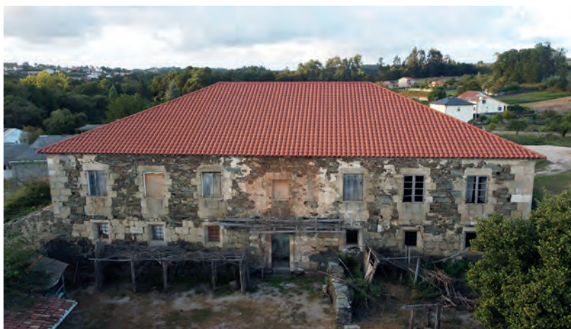
Imagen 8. Estado actual del Priorato de Bribes. 2022.
